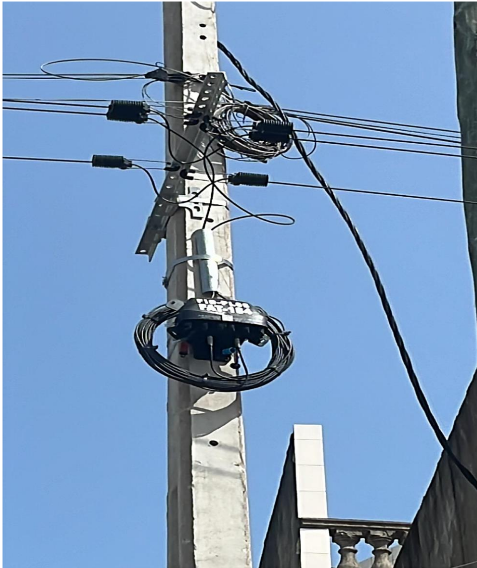
Figure 4 : Câble en fibre suspendu sur poteaux électriques
